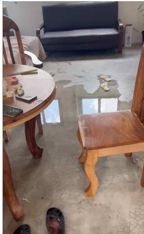
Inondation de l'appartement
